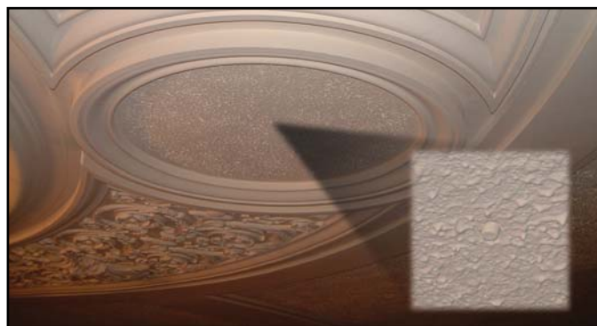
Copertura di un foro di campionamento VESDA nel soffitto di un teatro riccamente decorato
